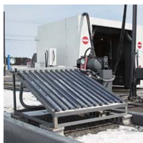
↑ 洗車機に導入した太陽熱温水システム
